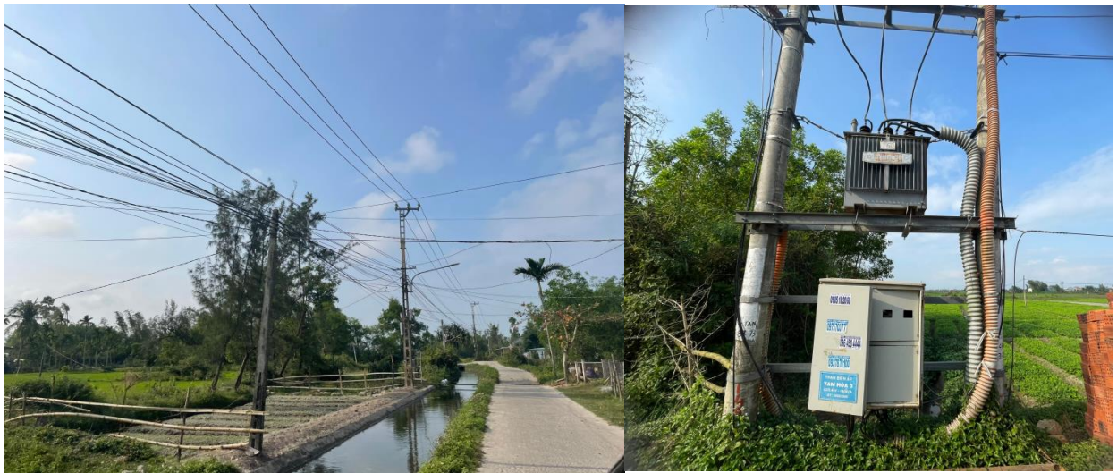
Hình 0.12. Hình ảnh cấp điện hiện trạng
